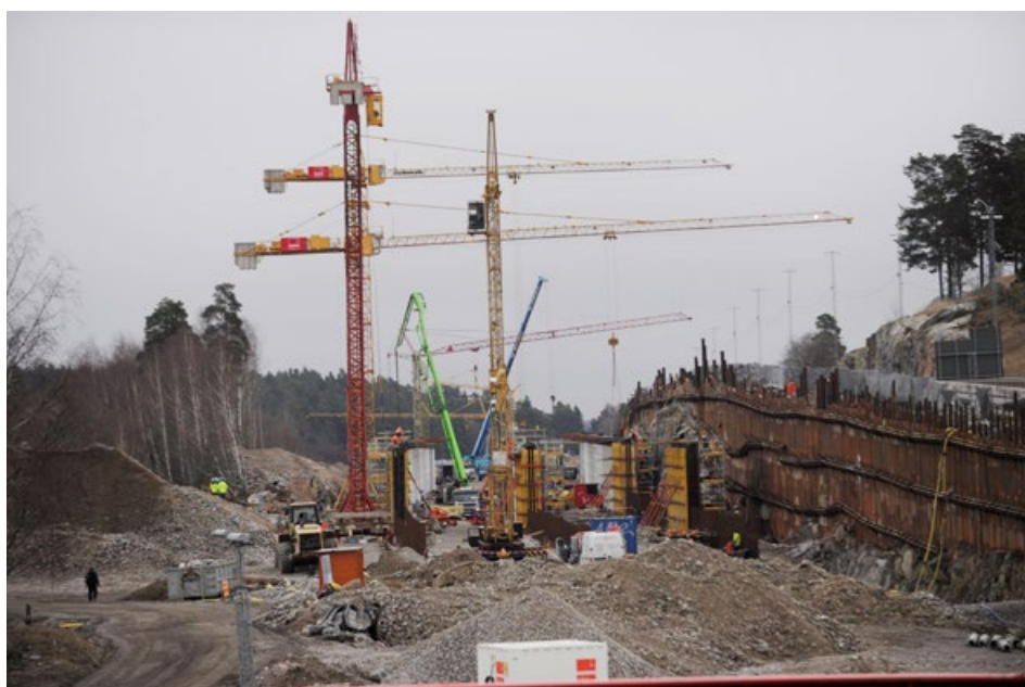
Det syntes inte på avstånd att en av kranarna var urspårad, men man var tvungen att stänga E18 Hjulstavägen.
