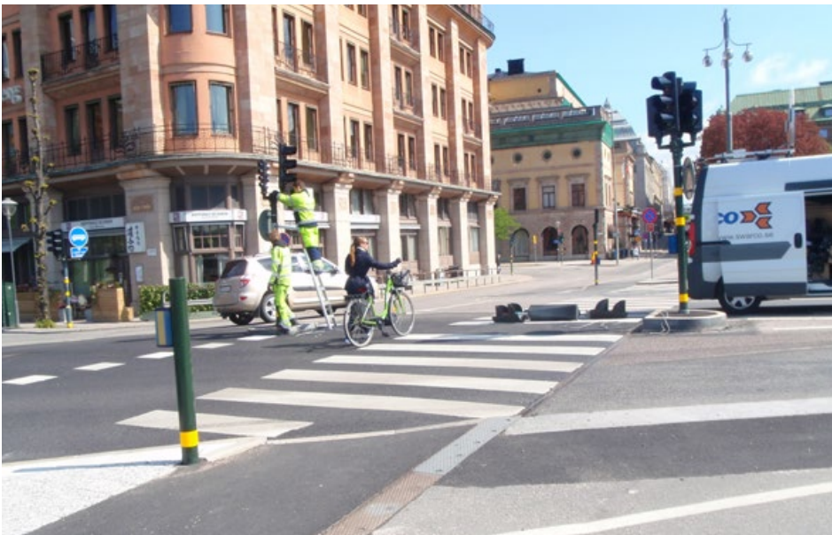
Stadens egen entreprenör lägger ut "snubbelhinder" på ett övergångsställe vid Tegelbacken i samband med arbeten med trafiksignaler.
